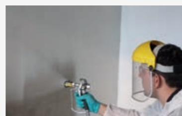
Maschineller Auftrag von PCI Polyflex® zum rissüberbrückenden Schutz gegen Karbonatisierung einer Tiefgaragenwand aus Beton
