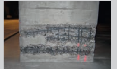
Freilegen eines mit Chlorid geschädigten Betons in einer Garage
