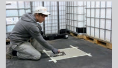
PCI Peciment® 50 in einer Produktionshalle zum Lagern und Abfüllen chemischer Produkte
