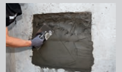
Den hochfesten Reparaturmörtel, z. B. PCI Nanocret® R4 PCC, satt und hohlraumfrei händisch oder maschinell auftragen
