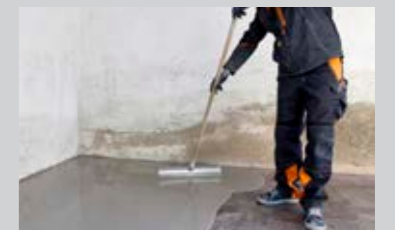
Angemischtes PCI Zemtec® 1K gleichmäßig verteilen und anschließend mit einer Stachelwalze entlüften.
