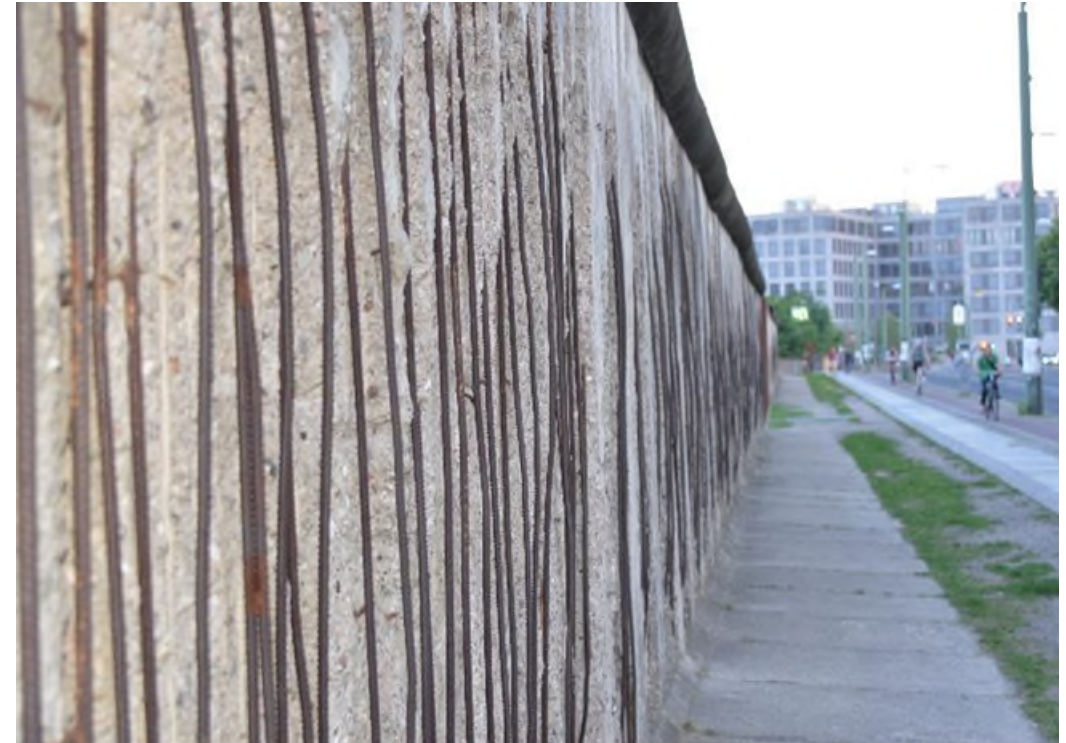
Freiliegende Bewehrung ohne Reparaturwunsch
