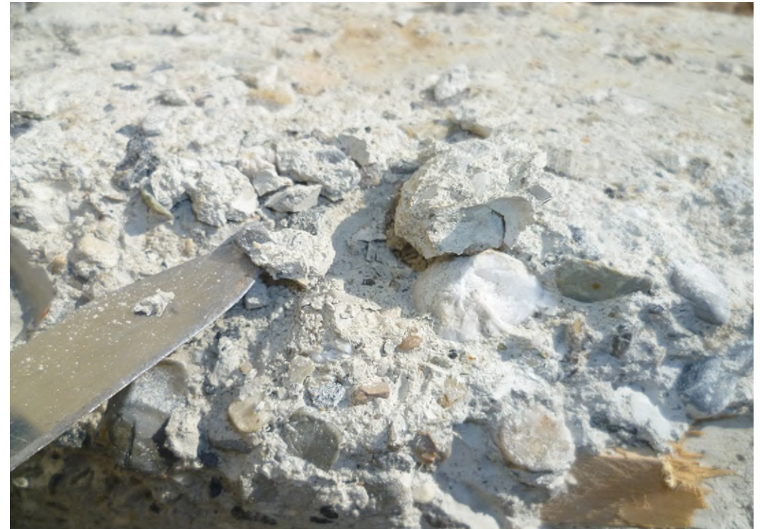
Abplatzungen, mangelnde Festigkeit
