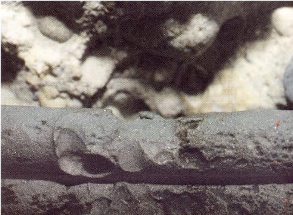
Korrosion der Bewehrung durch Salze (Lochfraß)
