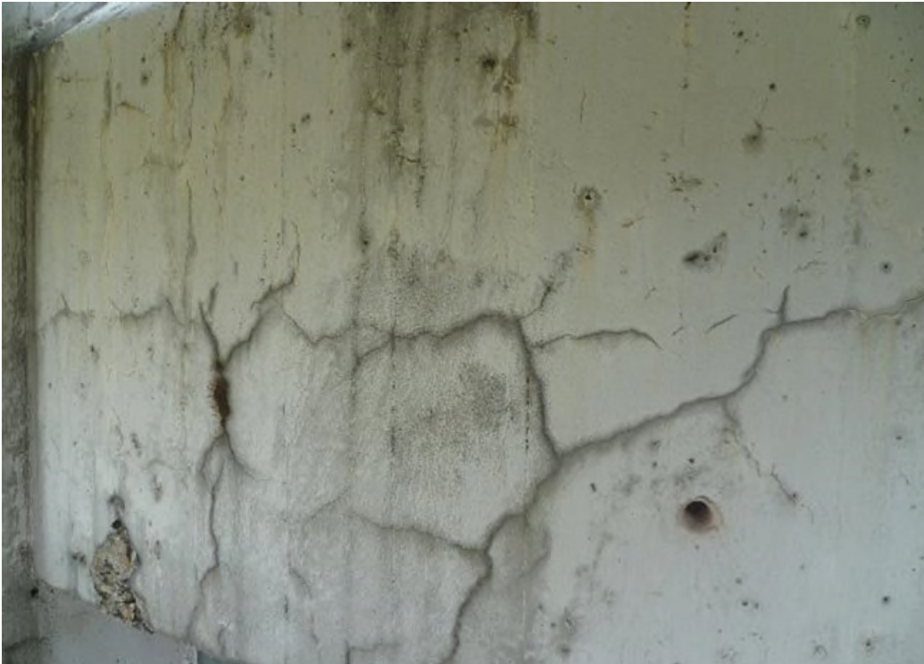
Rissbildungen mit Schadenspotential
