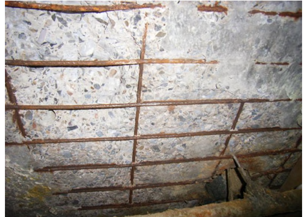
Korrosion der Bewehrung durch Wasser und Luft
