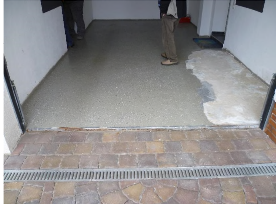
ablätternde Beschichtung wegen aufsteigender Feuchtigkeit
