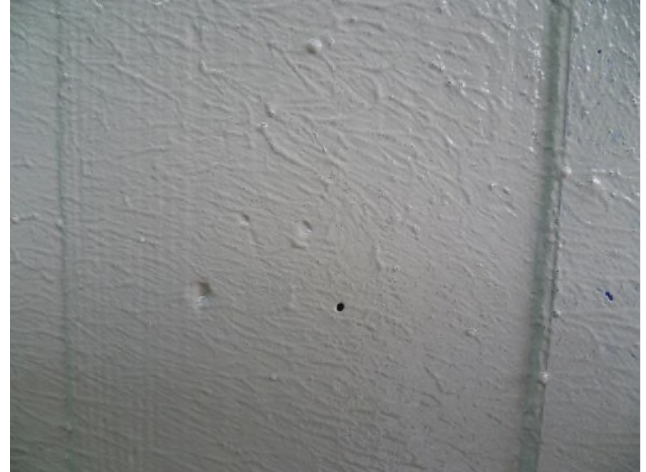
nach Anstrich werden Poren wieder sichtbar
