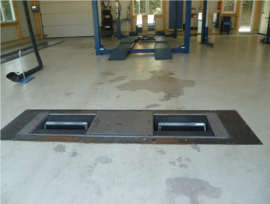
ablätternde Beschichtung wegen Feuchteintrag
