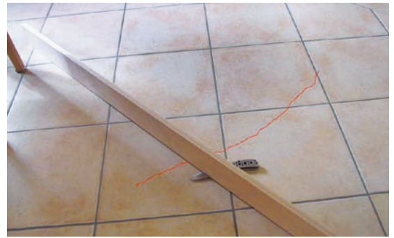
Abb. 5 – Riss im Keramikbelag (siehe rote Linie), verursacht durch Aufwölben und einhergehenden Bruch des Zementestrichs
