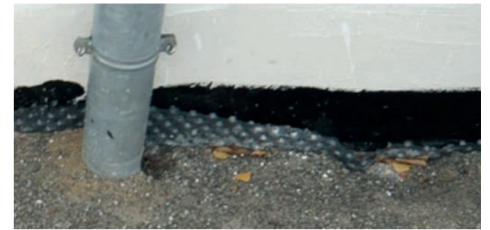
Planungsmangel einer Bauwerksabdichtung oberhalb der Geländeoberkante
