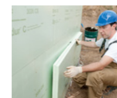
Vollflächige (oberhalb Grundwasserspiegel auch punktuell) Verklebung der Dämmplatten. Stöße der Platten anschließend verspachteln
