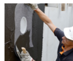
Einlegen einer PCI Gewebbahn im Bereich einer Rohrdurchführung bei drückendem Wasser (W2.1-E)
