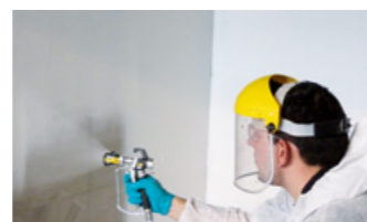
Maschineller Auftrag von PCI Polyflex zum rissüberbrückenden Schutz gegen Karbonatisierung einer Tiefgaragenwand aus Beton
