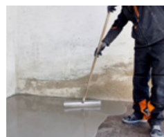
Angemischtes PCI Zemtec 1K gleichmäßig verteilen und anschließend mit einer Stachelwalze entlüften
