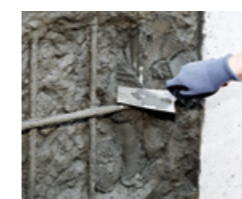
Kontaktschicht mit der ersten Lage Reparaturmörtel aufstreichen oder mit der Traufel aufkratzen
