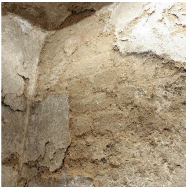
Kellerräume mit Feuchte- und Salzschäden vor der Sanierung
