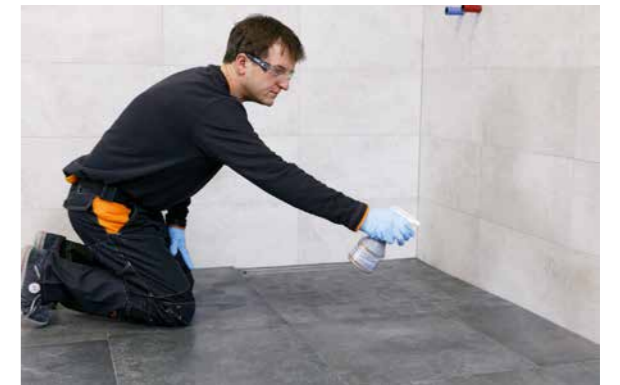
Vor dem finalen Waschgang wird nach ca. 60 Minuten PCI Durapox Finish (flüssig) auf die Fläche aufgesprüht. Alternativ kann auch PCI Durapox Finish (Konzentrat) direkt in das Waschwasser hinzugegeben werden.
