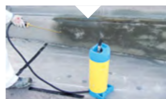
Manueller Auftrag einer PCI Silconal-Hydrophobierung als nicht filmbildende wasser- und schmutzabweisende Maßnahme
