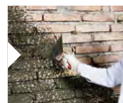
Im Sanierputzsystem wird der Spritzbewurf PCI Saniment HA netzförmig mit einem Deckungsgrad von ca. 50 Prozent aufgebracht
