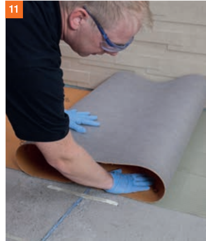
Nach ca. 40 Minuten wird PCI Pecilastic® U mit PCI Flexmörtel® S2 als Entkopplungsschicht auf dem Estrich verklebt.
