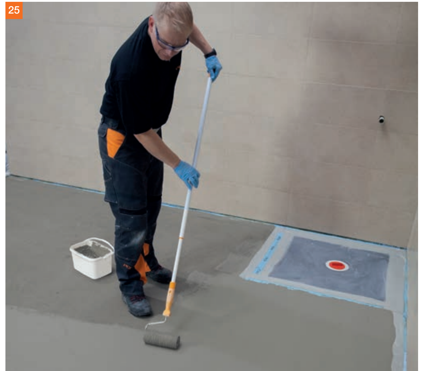
25 Nach ca. 1 Stunde erfolgt der jeweils nächste Auftrag mit PCI Seccoral® 1K / 2K Rapid bis zum Erlangen der Mindesttrockenschichtdicke von 2 mm.
