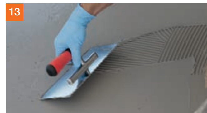
PCI Seccoral® 2K Rapid mit 6er Zahnung aufkämmen und anschließend glattstreichen; nach ausreichender Trocknung der ersten Schicht den zweiten Auftrag in gleicher Weise vornehmen.
