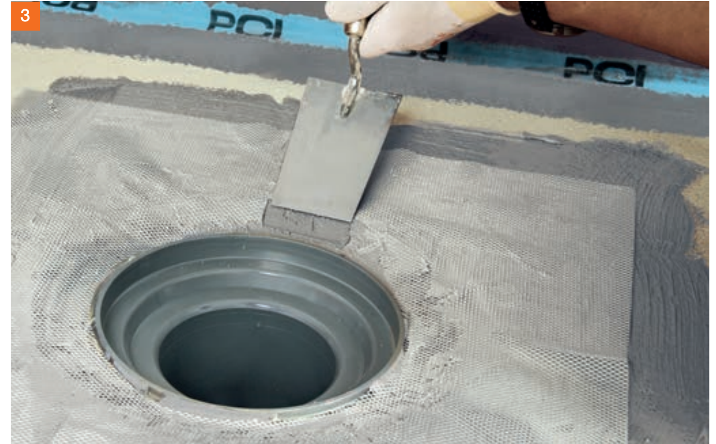
... anschließend das Gewebe entsprechend dem Gefälleverlauf andrücken und mit PCI Seccoral® 1K / 2K Rapid überarbeiten. Nach Durchtrocknung (ca. 1 Stunde) erfolgt der 2. Arbeitsgang mit PCI Seccoral® 1K / 2K Rapid.
