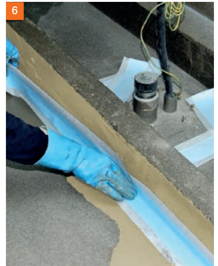
Danach wird zum Beispiel PCI Pectape® 120 oder PCI Pectape® Objekt eingelegt und übergearbeitet.
