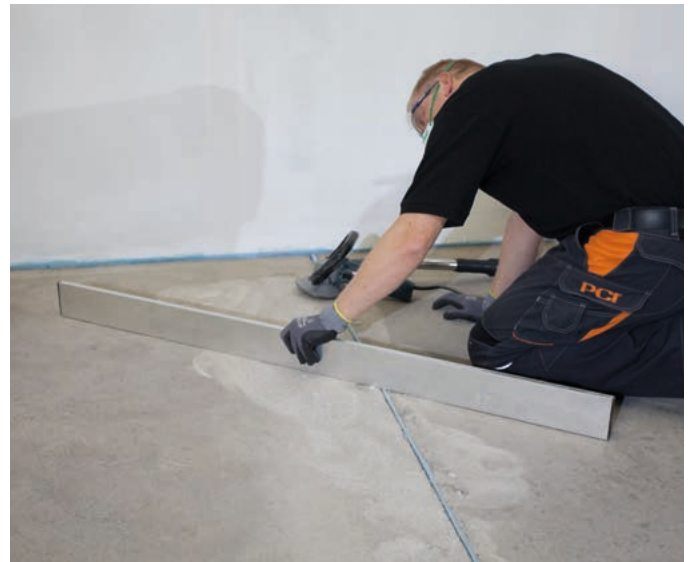
Abb. 3 – Nach Norm noch zulässig, für die Verlegung von Großformaten nicht mehr ausreichend; im vorliegenden Fall ist ein Ausgleich erforderlich.
