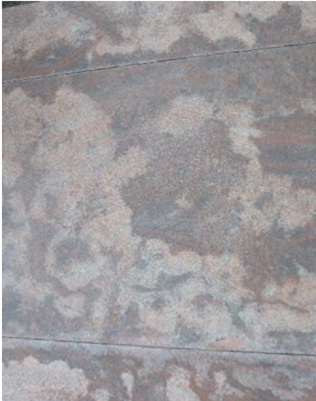
Wassereinlagerung führt zur Verdunkelung
