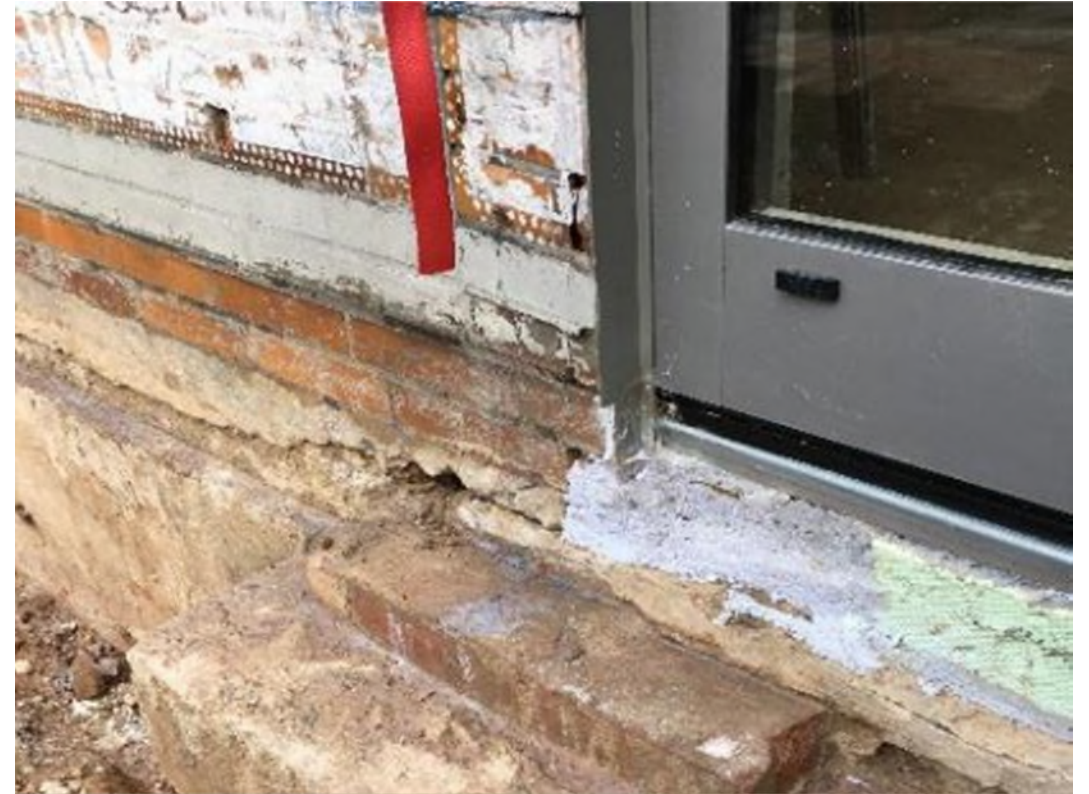
Wassereintritt ins Gebäude durch fehlerhafte Abdichtung
