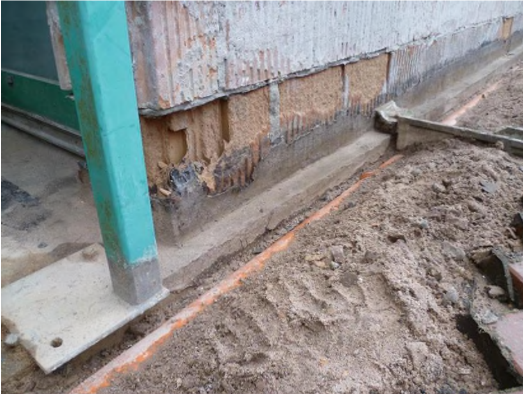
Durch Wasser und Frost zerstörter Sockelbereich
